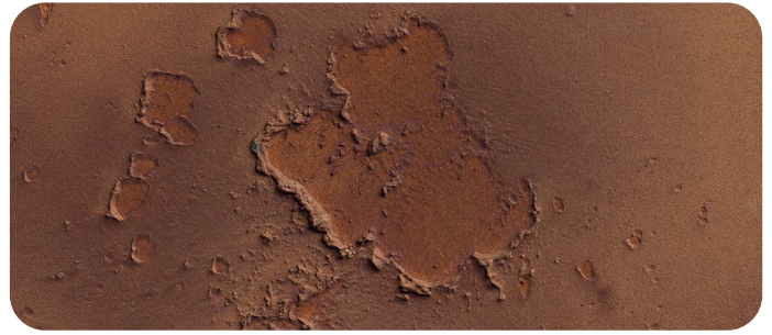
330 Rost tief | rust deep
